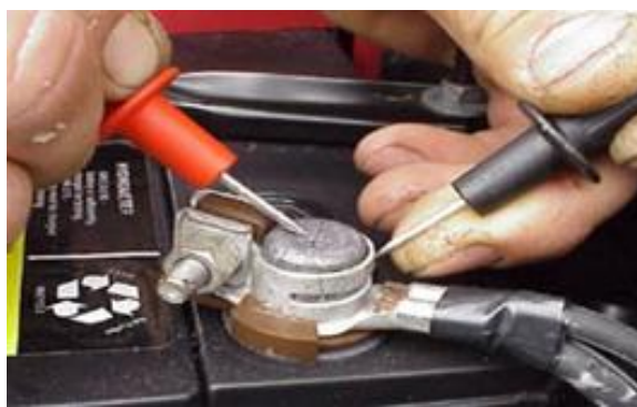
Hình 2.16: Kiểm tra độ sụt áp ở kẹp cực.
